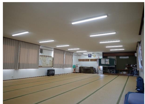
2階集会室の照明器具のLED化
